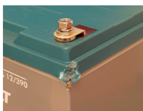
Extern skada = BYT UT
