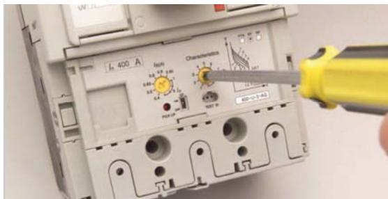
400A brytare med NE-skydd inkl. AG (Jordfelsskydd)
